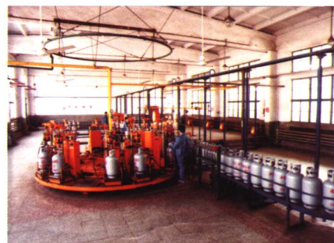
引进法国道达尔公司液化气灌装设备
