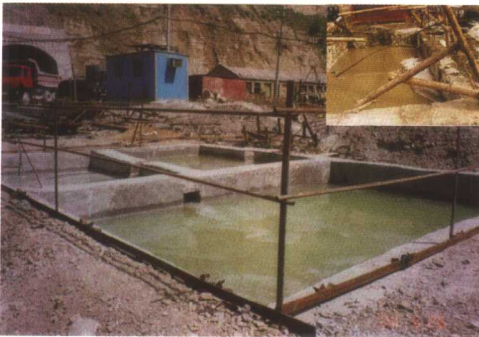
扩建后的生产废水沉淀池
