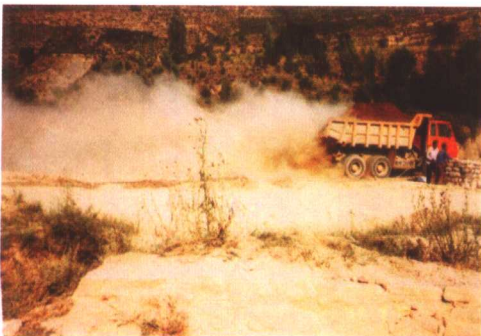
施工道路扬尘严重
