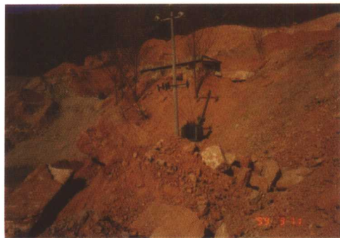
违规弃渣掩埋配电变压器
