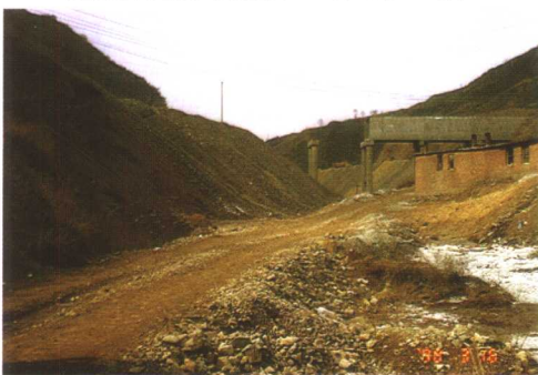
违规弃渣影响渡槽施工
