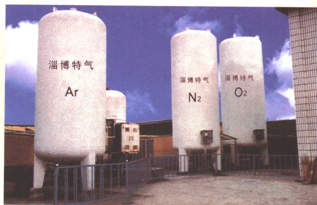
淄博特种气体厂特气储存设备
