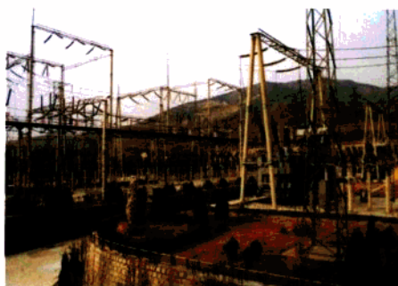
220千伏芝罘变电站
