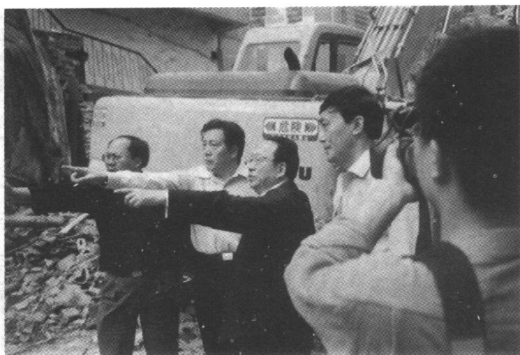
杨正午在火灾坍塌现场
