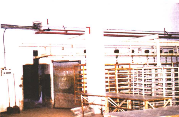
冷藏库内的 制冷机组
