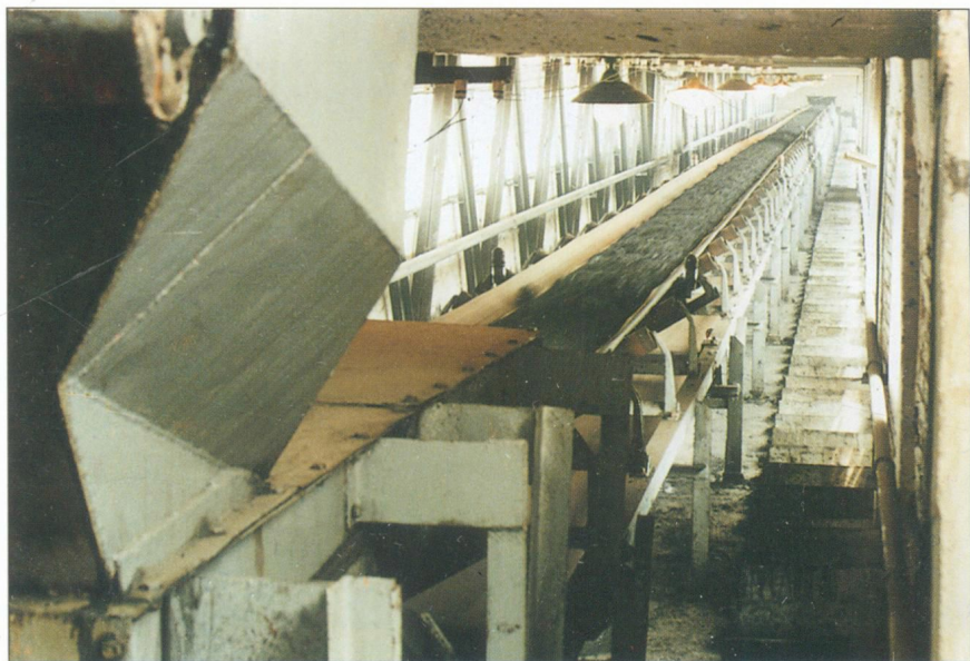
横河煤矿皮带输煤设备
