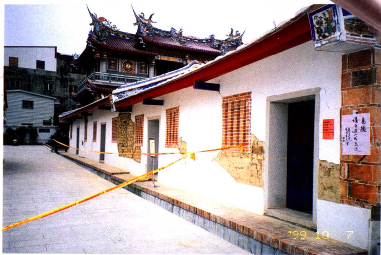
南投藍田書院古跡已成危樓
