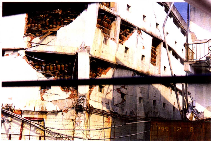
嚴重震損的埔里酒廠一景
