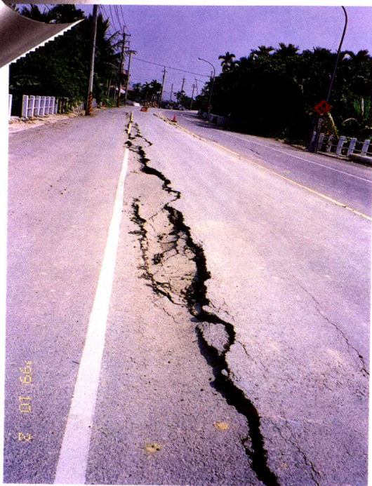
長長的裂痕，大地的傷口
