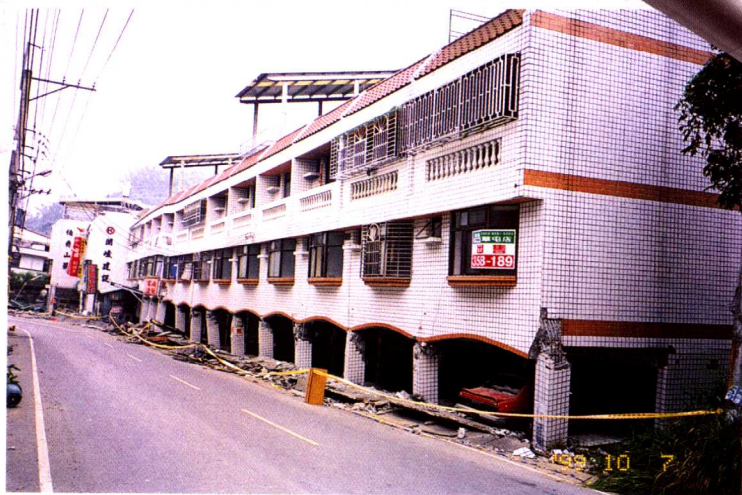
南投東山路整排大樓全部傾斜
