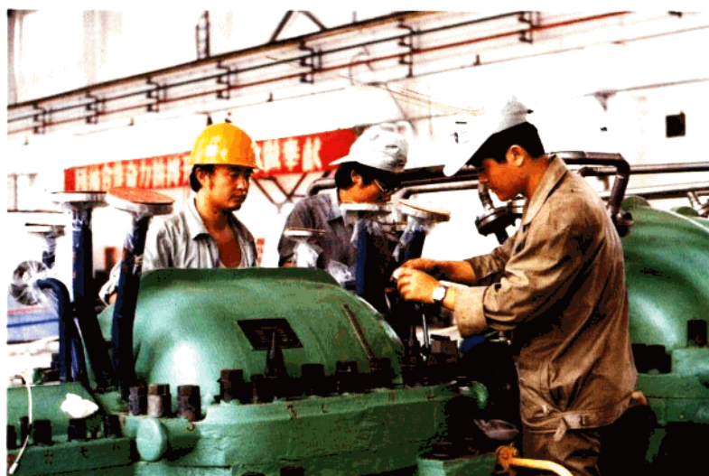
在检修中的氧气压缩机
