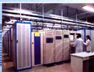
西部数据中心机房
