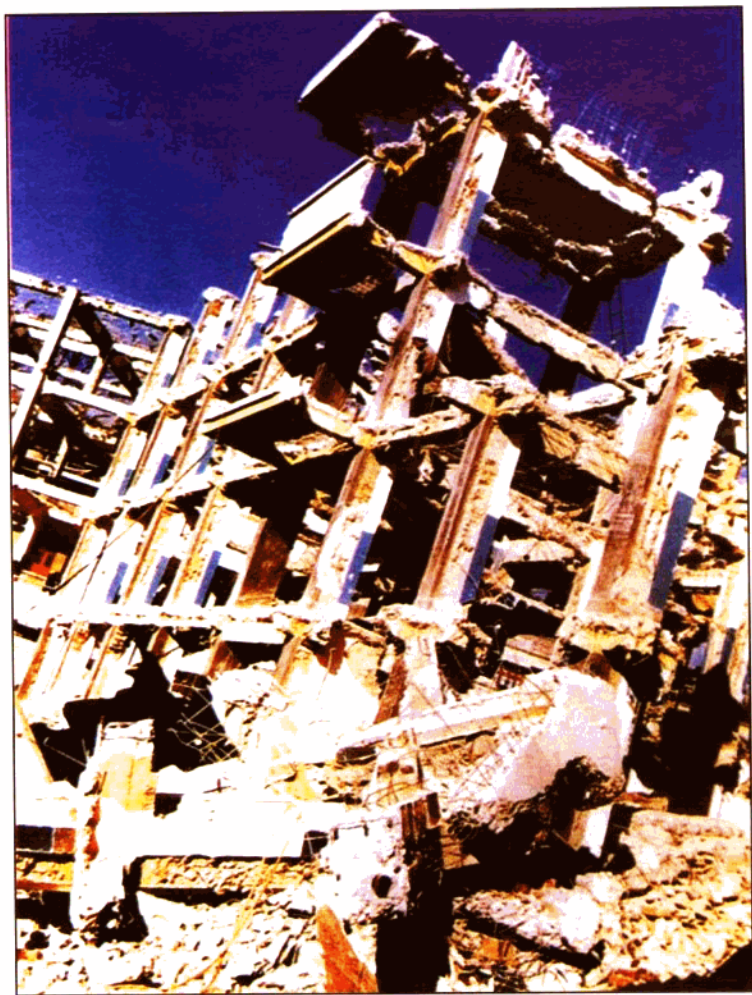
地震造成楼房倒塌
