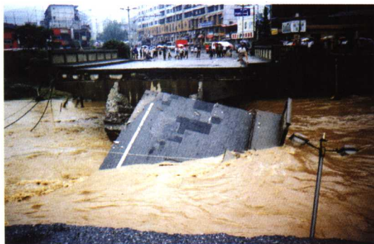
苏仙大桥被洪水冲毁的情景
