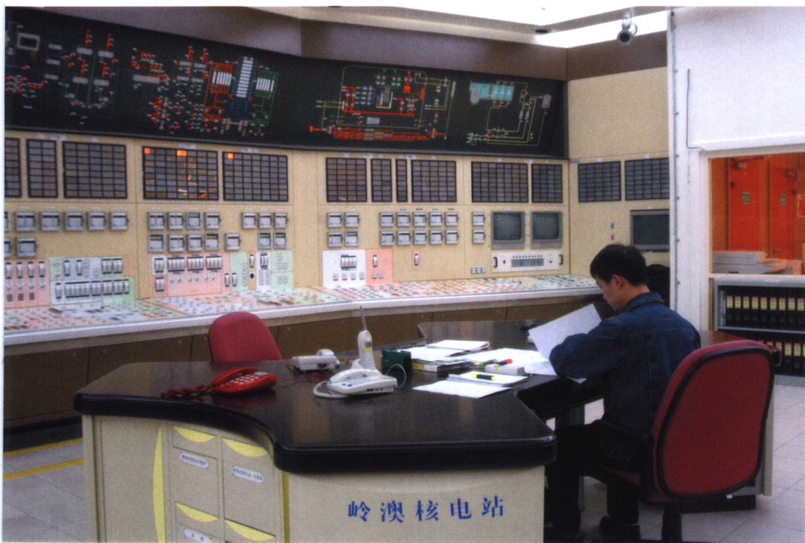
■ 岭澳核电站主控制室
