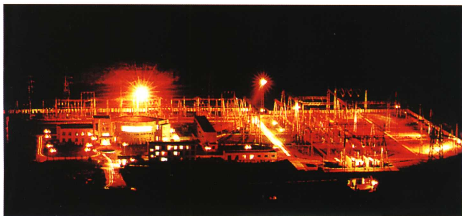
330 千伏延安变电所
