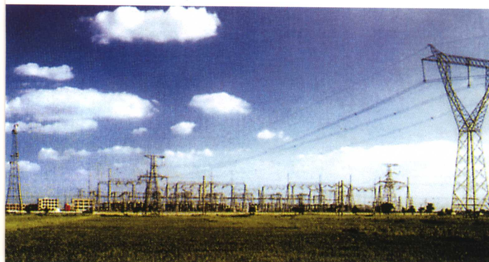
陕西电网南部 330 千伏汉中变电所
