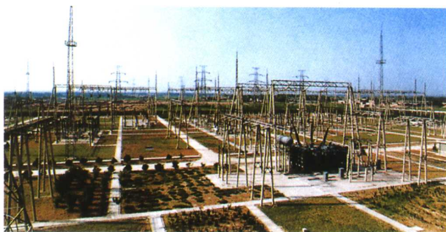
330 千伏西安北郊变电所
