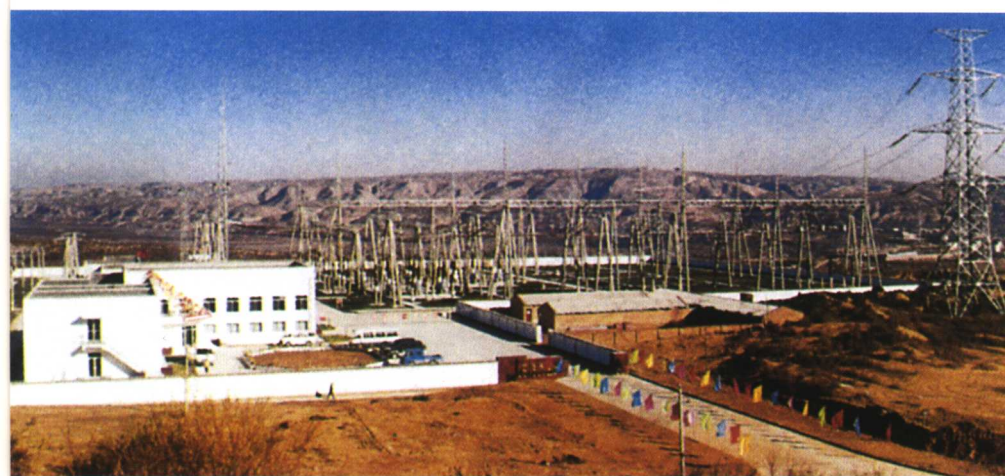
陕西电网北部 330 千伏神木变电所
