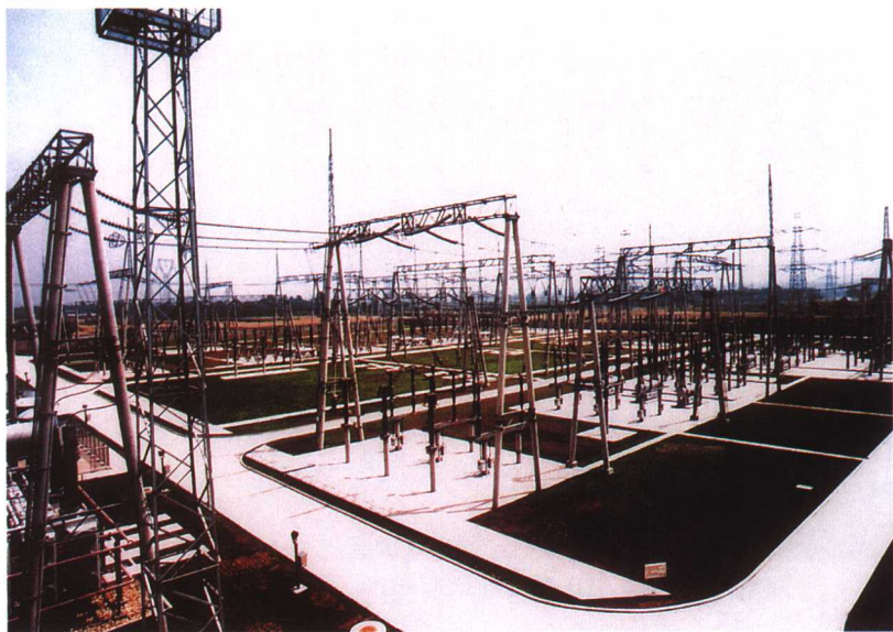
陕西首座 330 千伏综合自动化变电所——西安东郊变电所
