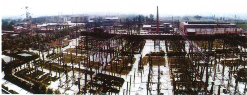
330 千伏西安南郊变电所
