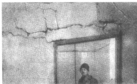
图 1-6 匈牙利一码头建筑物墙体开裂
