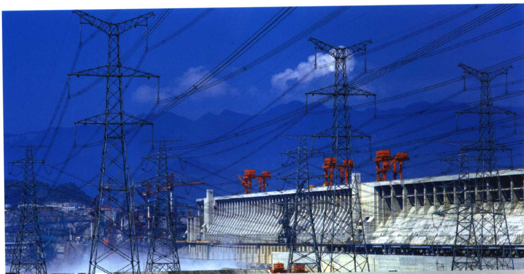
三峡输变电工程
