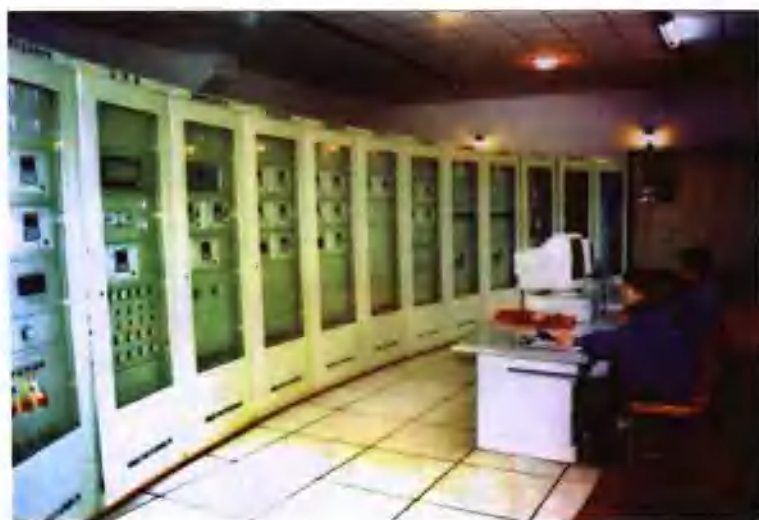
热 电 厂 主 控 室
