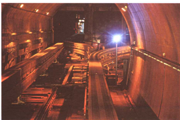
大坪地下站折返线道岔
