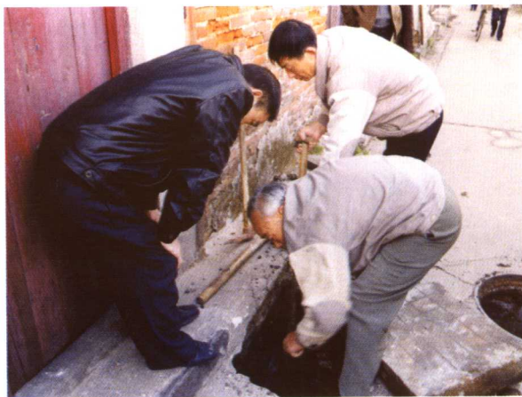
武昌区房地公司吴天祥小组义务为社区居民疏通下水道
