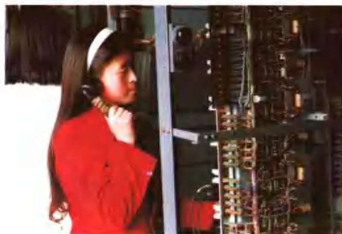
市内自动电话 交换机房
