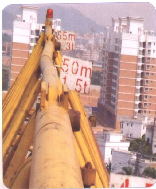
吊臂主弦杆变形（一）
