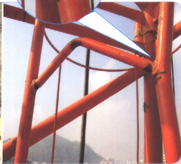
爬梯受外力冲击开裂
