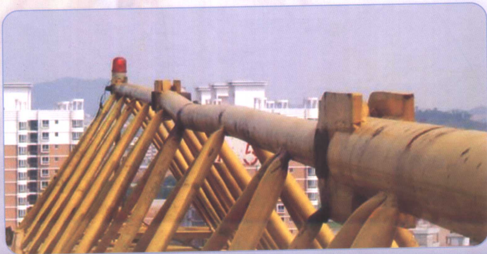
吊臂主弦杆变形（二）
