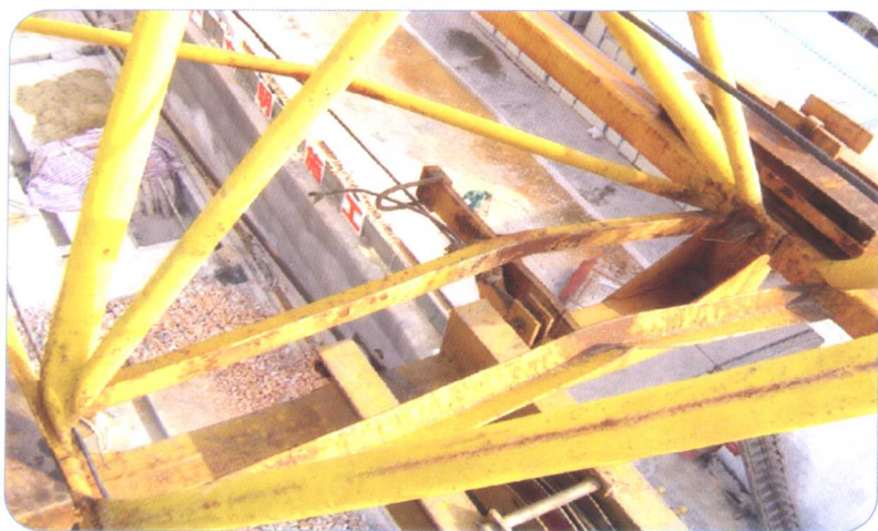
吊臂横附杆弯曲变形
