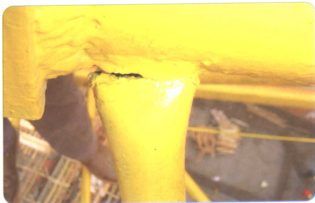
吊臂斜支撑与主弦杆连接处开裂
