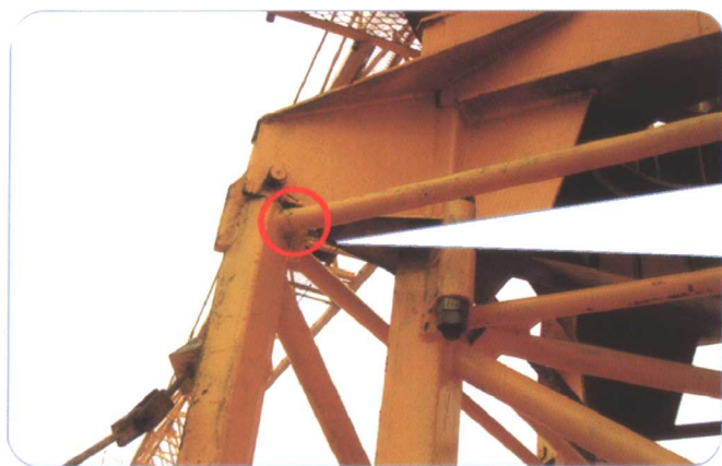
顶升套架横支撑断裂
