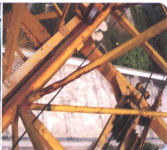
吊臂斜支撑变形 (二)
