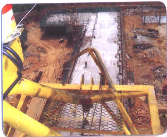
吊臂尖端护栏断裂
