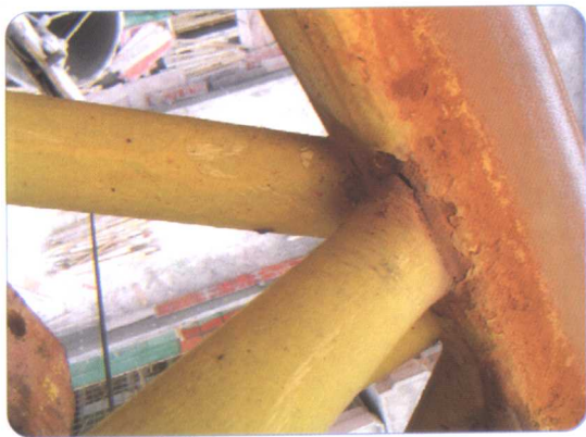
吊臂斜支撑与下弦杆连接处开裂
