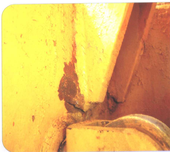
顶升套架耳板焊缝撕裂
