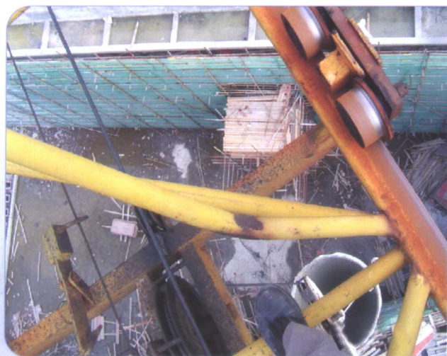
吊臂斜支撑变形 (一)
