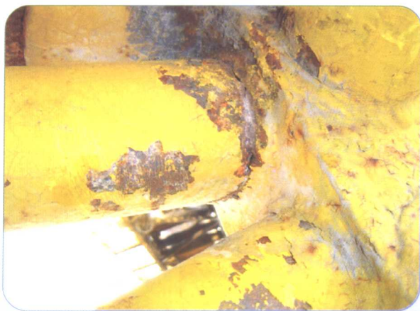
塔机塔身标准节横支撑开裂
