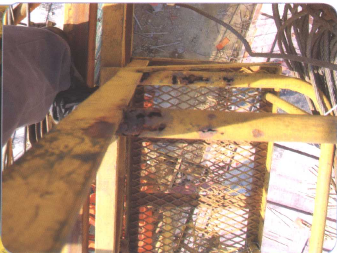
变幅小车护栏已有多处锈穿
