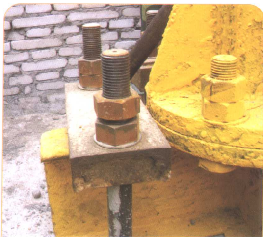
基础压板螺栓松动
