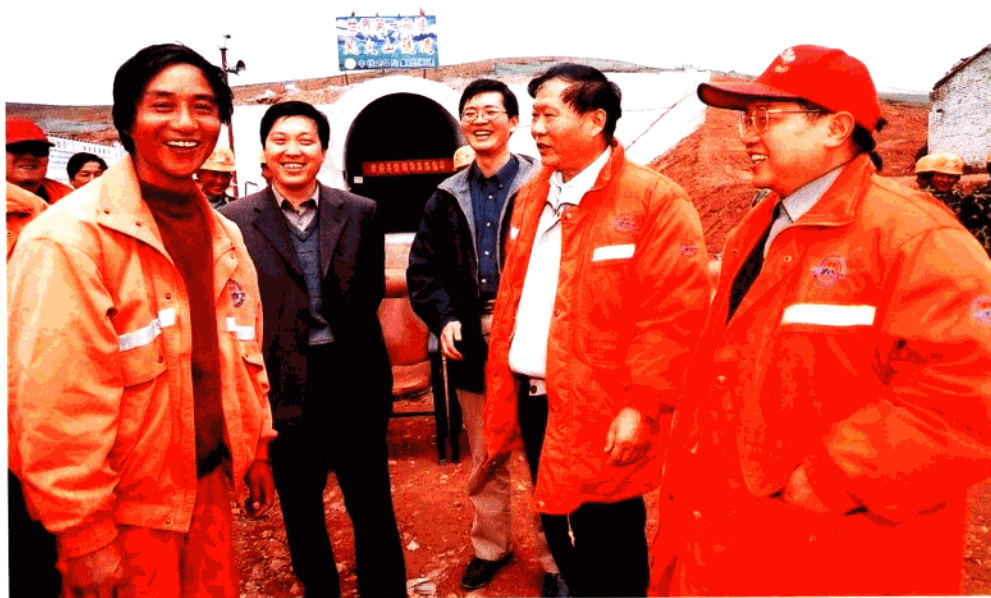
2003年8月,在青藏铁路风火山隧道施工现场 (右2为王梦恕)(李培安 摄)
