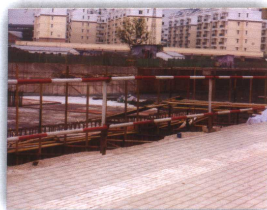
基坑临边防护
