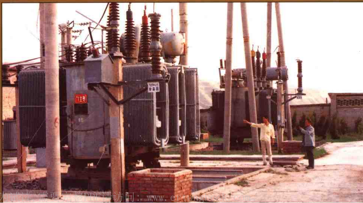
恭门变电所变电机组
