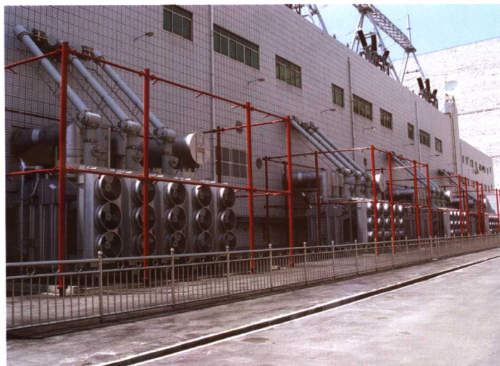
电站主变压器
