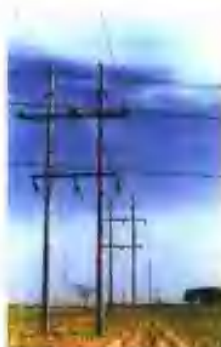
关中110KV输变电工程
