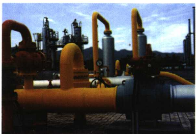
梁平天然气输气站
