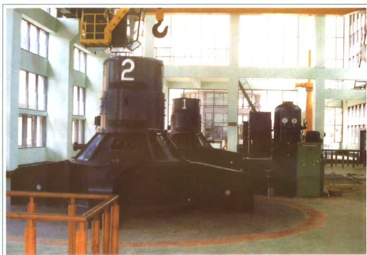
中国上海外经（集团）有限公司承建的缅甸照济电站于1998年10月27日顺利竣工
