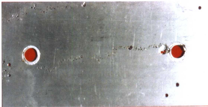
图 12.1.1 1Cr18Ni9Ti 不锈钢隧道腐蚀形貌(见正文 290 页)
