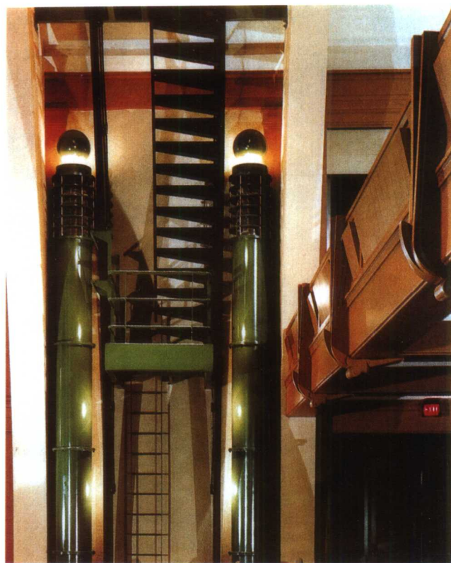
迪林汉大厅中通风柱的照明，为巨大的室内空间增添了一层别致的环境照明层次
