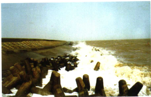
潮流冲刷孤东海堤堤角
