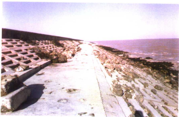
波浪冲击后的海堤护坡
