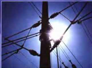
铁路电气化接触网系统
