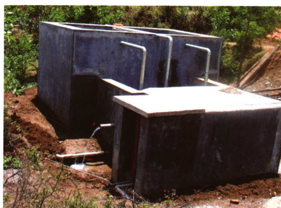
慢沙过滤系统
