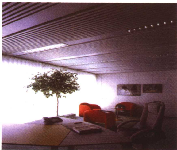
条型金属板吊顶
