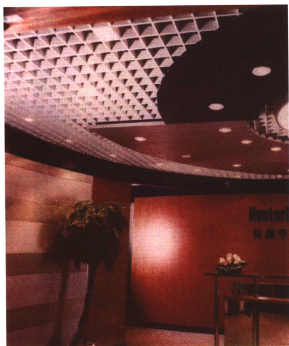
金属组合吊顶
