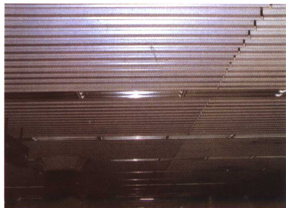
条型金属板吊顶
