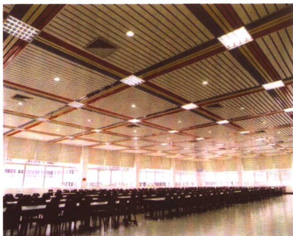
条型金属板吊顶
