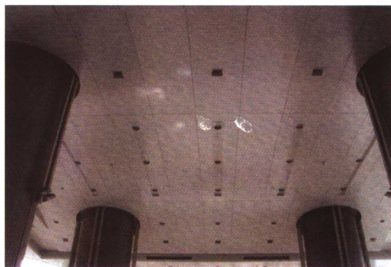
条型金属板吊顶
