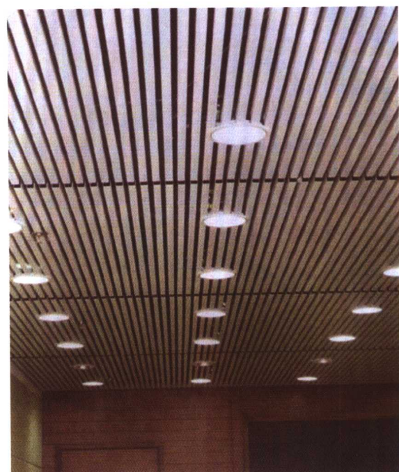
条型金属板吊顶
