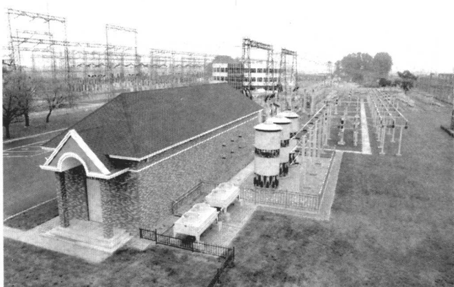
图 1-7 220kV 鞍山红一变电站 SVC 装置视图
