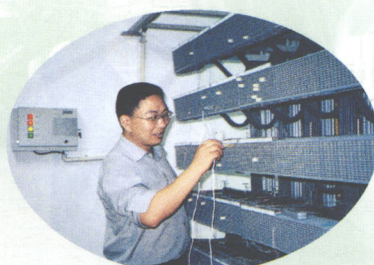
现代化的通信设备
