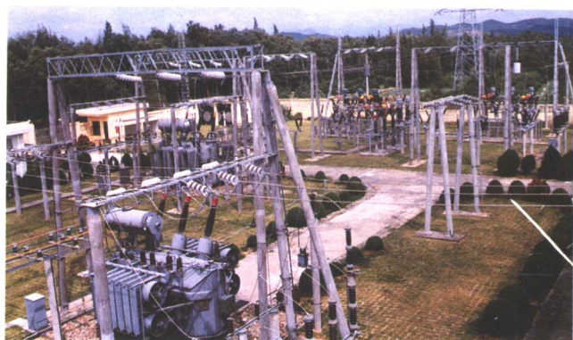
西坑 110 千伏变电站一角
