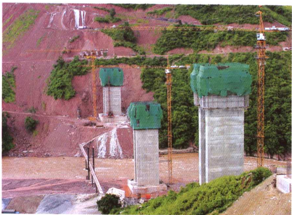
阿墨江特大桥磨黑岸滑坡
