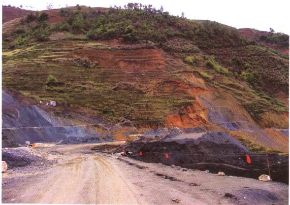
南溪立交匝AK0+100~AK0+250滑坡
