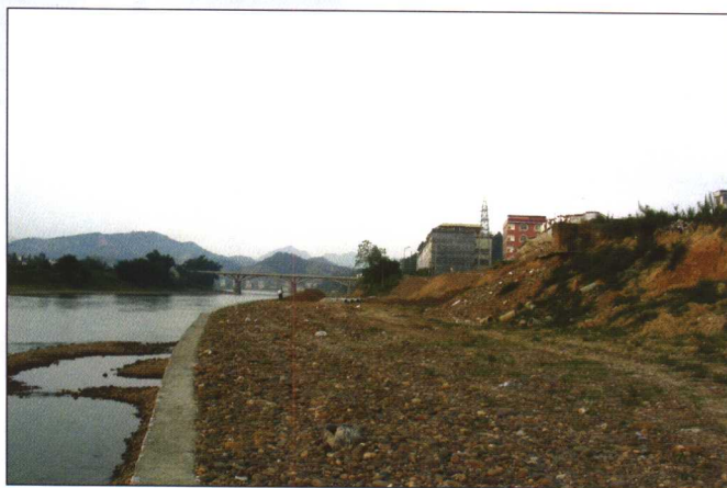
平乐县城区新建防洪堤一角
