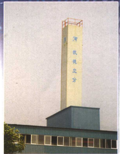
合肥成钢钢铁有限公司 KDON-1000/1000 型空分设备
