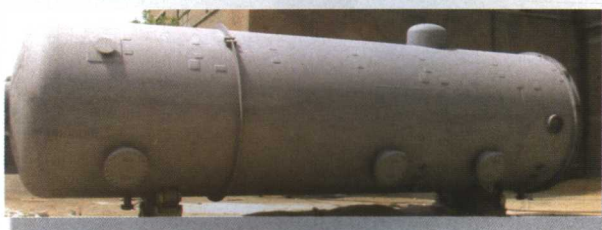
38000型空分設備配套的水冷塔
