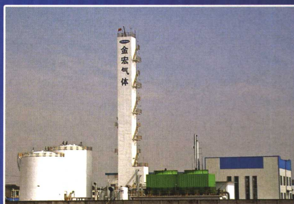
苏州 3000m³/h 液体空分装置全景
