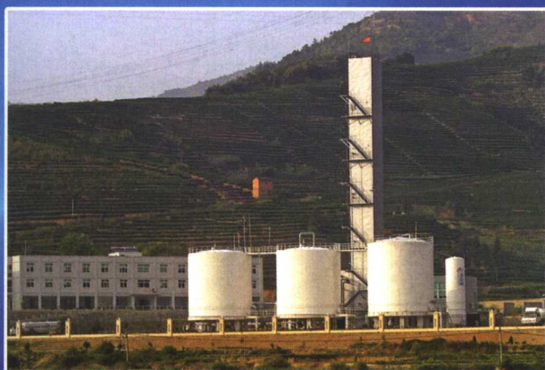
福建寿宁星耀公司 3500m³/h 液体空分装置全景
