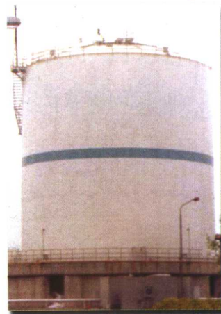
2000m 3 低温液体贮槽
