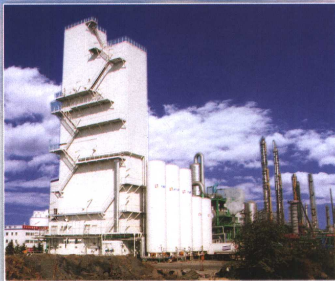
● 安装在山东华鲁恒升化工有限公司的40000 \text{m}^3/\text{h} 内压缩流程大型空分设备
