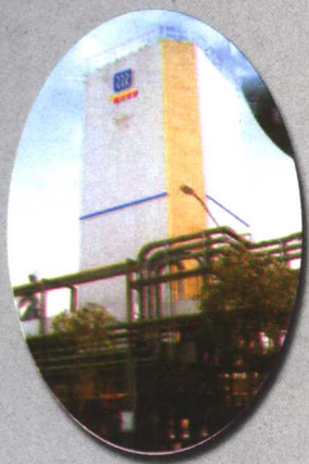
500m 3 低温液体贮槽
