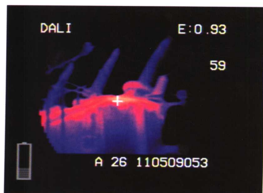
图 2-36 主变压器有载调压局部温度高红外热像
