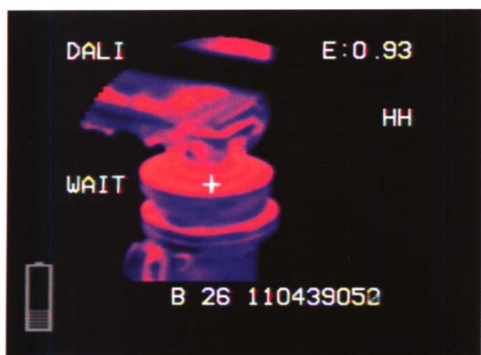
图 2-58 主变压器强油循环冷却器红外热像
