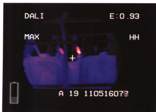
图 2-42 农网 35kV 变电站主变压器套管红外热像
