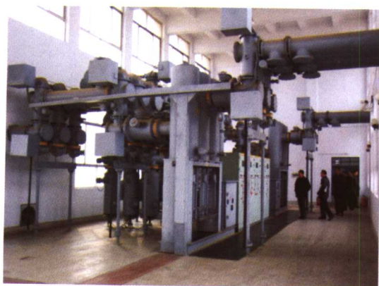
图 3-43 110kV GIS 组合电器运行可见光照片
