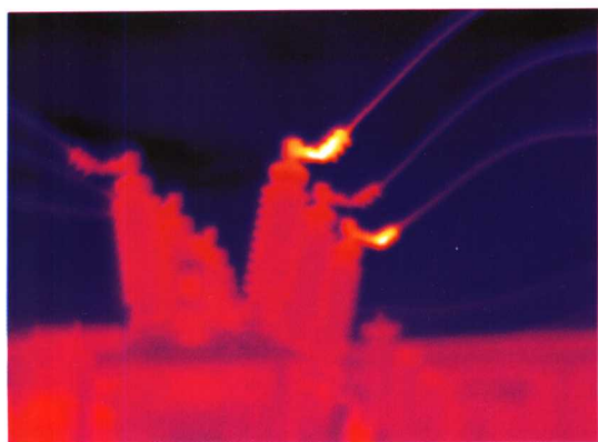
图 3-37 农网 35kV 多油断路器套管接头红外热像
