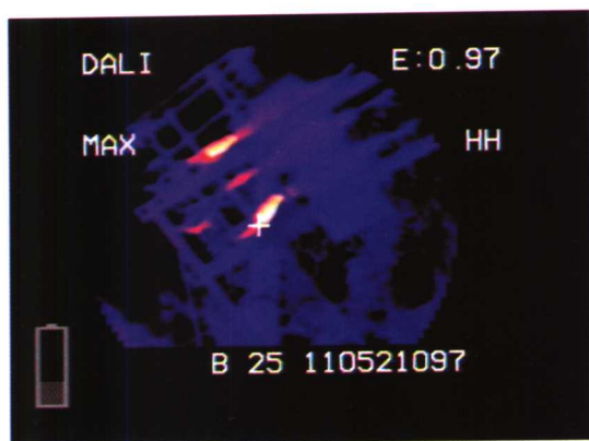
图 3-35 城网 10kV 六氟化硫断路器接头过热 红外热像
