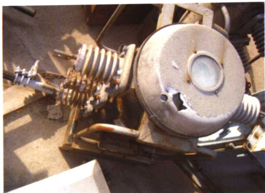
图 3-44 接线端过热放电烧坏的 10kV 断路器 可见光照片
