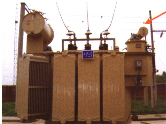
图 2-45 农网 35kV 变压器运行可见光照片
