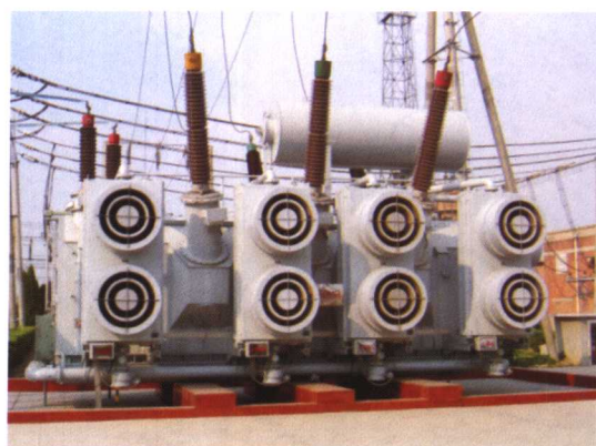
图 2-35 220kV 主变压器运行可见光照片
