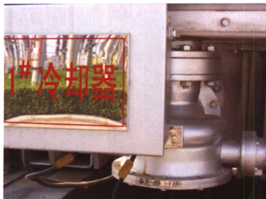
图 2-59 主变压器强油循环冷却器运行可见光照片
