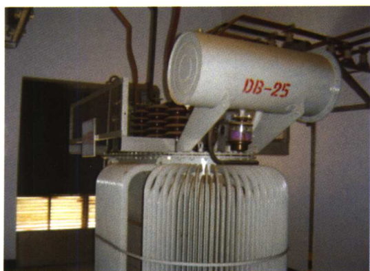
图 2-64 500kV 变电站运行中的站用变可见光照片
