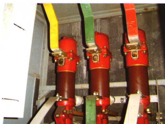
图 3-19 10kV 少油断路器运行中可见光照片
