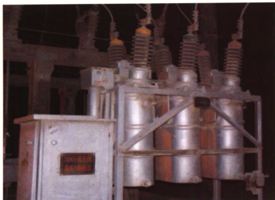
图 3-47 35kV 多油断路器可见光照片
