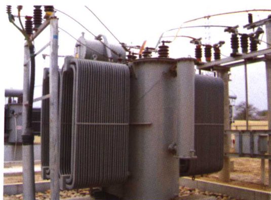
图 2-43 农网 35kV 变电站主变压器可见光照片
