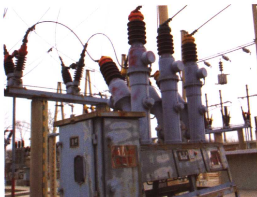
图 3-25 35kV 六氟化硫断路器运行中可见光照片
