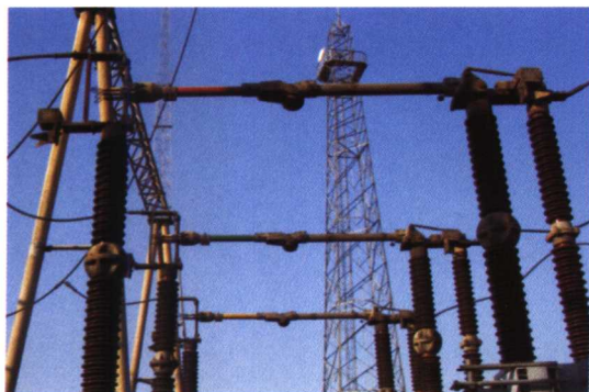
图 4-24 220kV 隔离开关运行可见光照片
