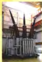
三绕组变电站 SFP-840MVA/550kV 发电机变压器完成试验
