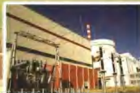
出口巴基斯坦恰希玛核电站 SFP-370MVA/238 kV 核发电机主变压器
