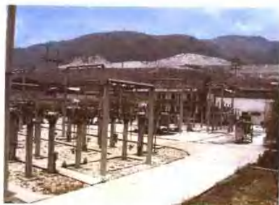
35 千伏狮山变电站
