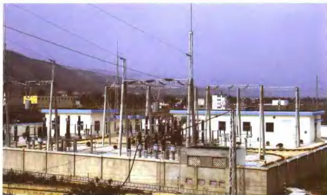
110 千伏桑园变电站
