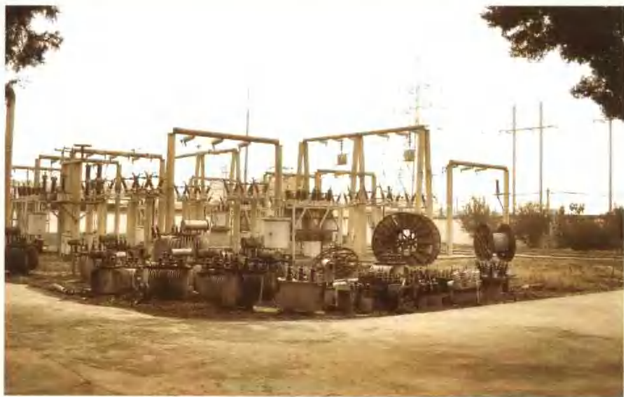
通海县首座 35 千伏桑园变电站
