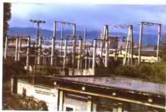
35 千伏沙沟嘴二级变电站
