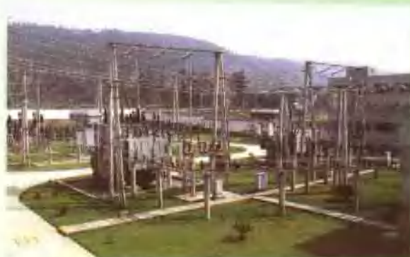
110 千伏四街变电站
