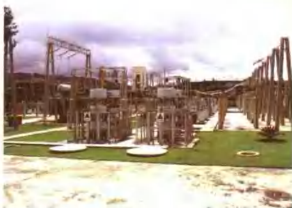
110 千伏虎山变电站
