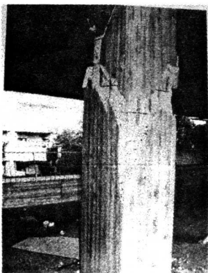
图 1.11 混凝土柱被剪断压溃
