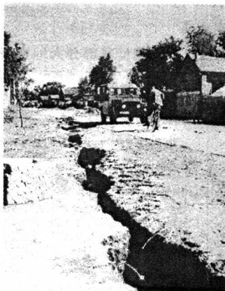
图 1.7 地面出现地裂缝
