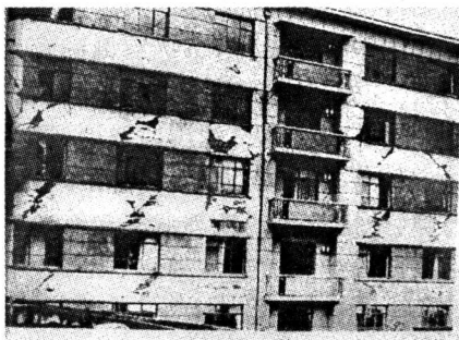
图 1.10 砌体结构墙面开裂
