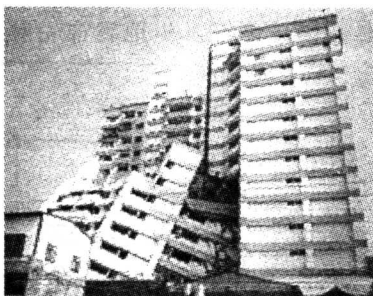
图 1.13 房屋倾斜倒塌
