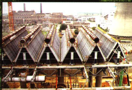
大唐云冈 200MW 机组配套直接空冷凝汽器
