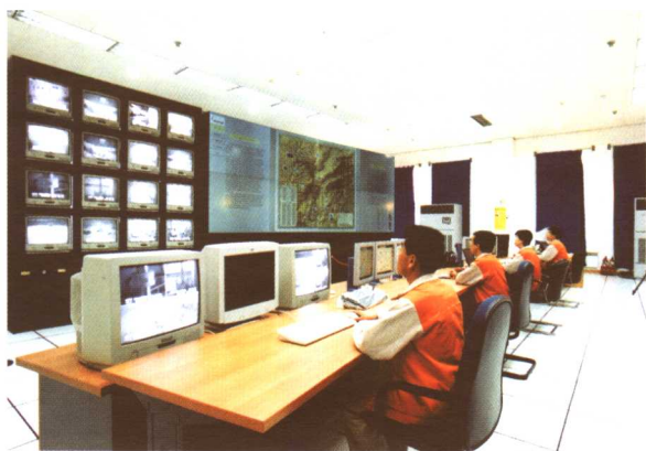
引黄工程应用自动化系统进行输水调度
