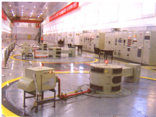
引黄工程泵站厂房内景
