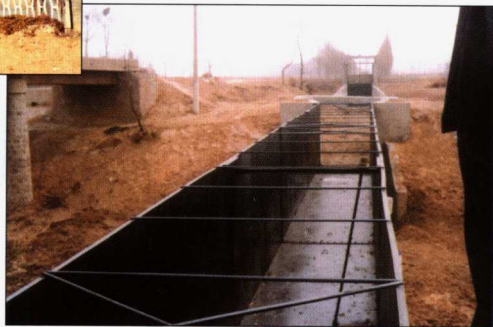
■ 钢板活动渡槽 被评为国内领先水平
