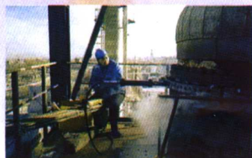
北京燕山石化催化裂化装置管线泄漏封堵处理
