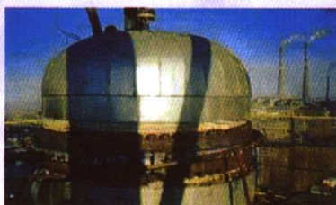
玉门石油管理局炼化总厂重整立式换热器泄漏
