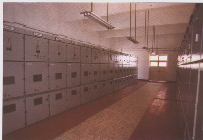
变电所高压室
