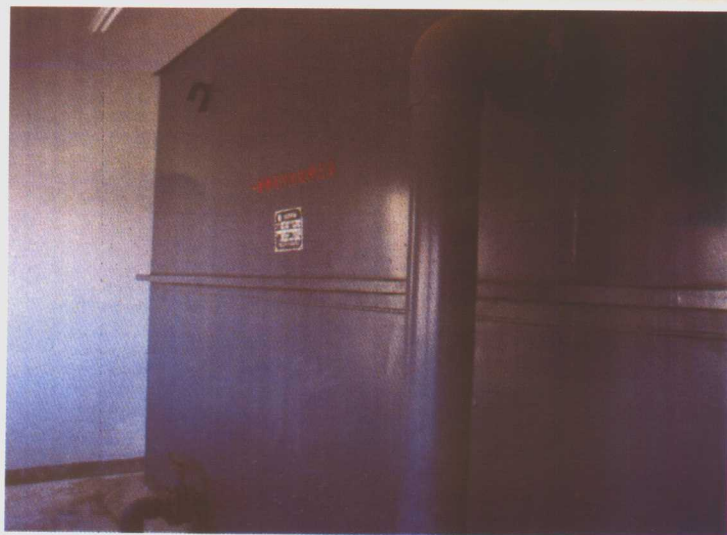
辽中站污水处理站
