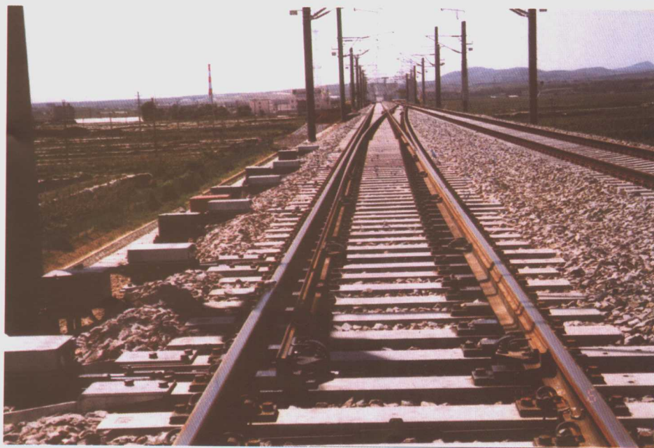
38号大号码道岔
