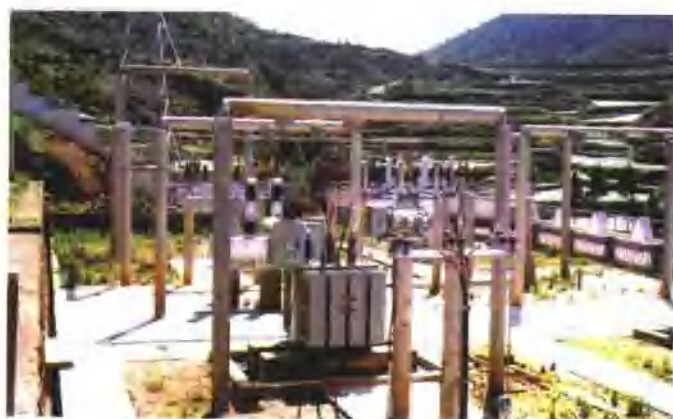
2000年12月投入运行的铜 厂35千伏变电站
