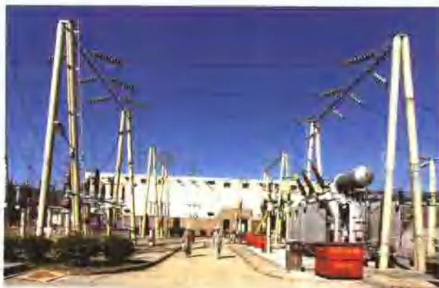
1995年2月投入运行的易门110千伏变电站
