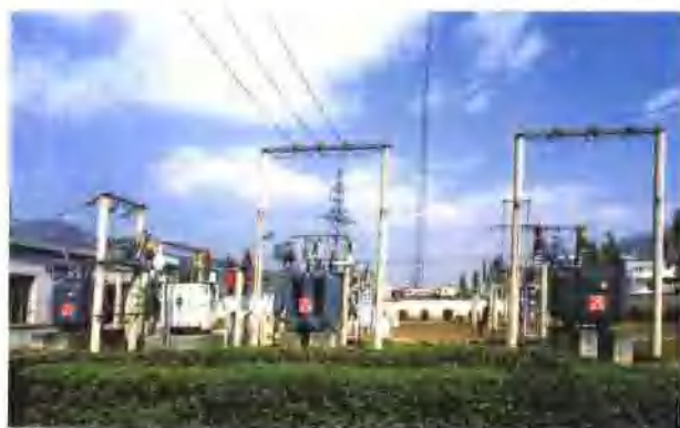
1968年4月，从大山凹移往六街重建的 易门县第一座35千伏变电站——扒河变电站
