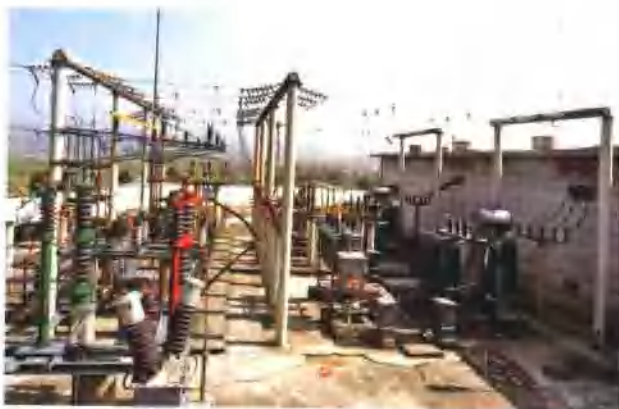
1967年建成投运的易门罗所35千伏变电站
