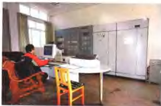
碧邦电站控制室
