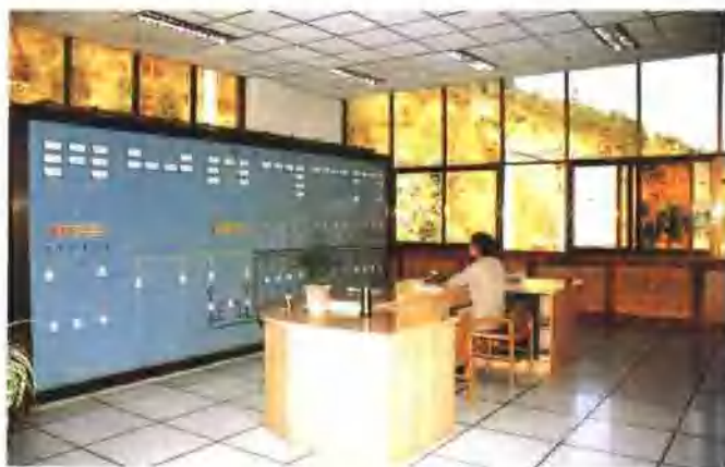
浦贝变电站配电室
